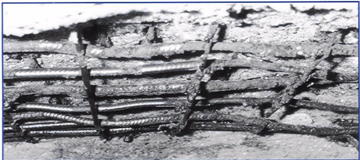
Slika 4: Po požaru; odpadanje betona tudi do 40 cm globoko.
