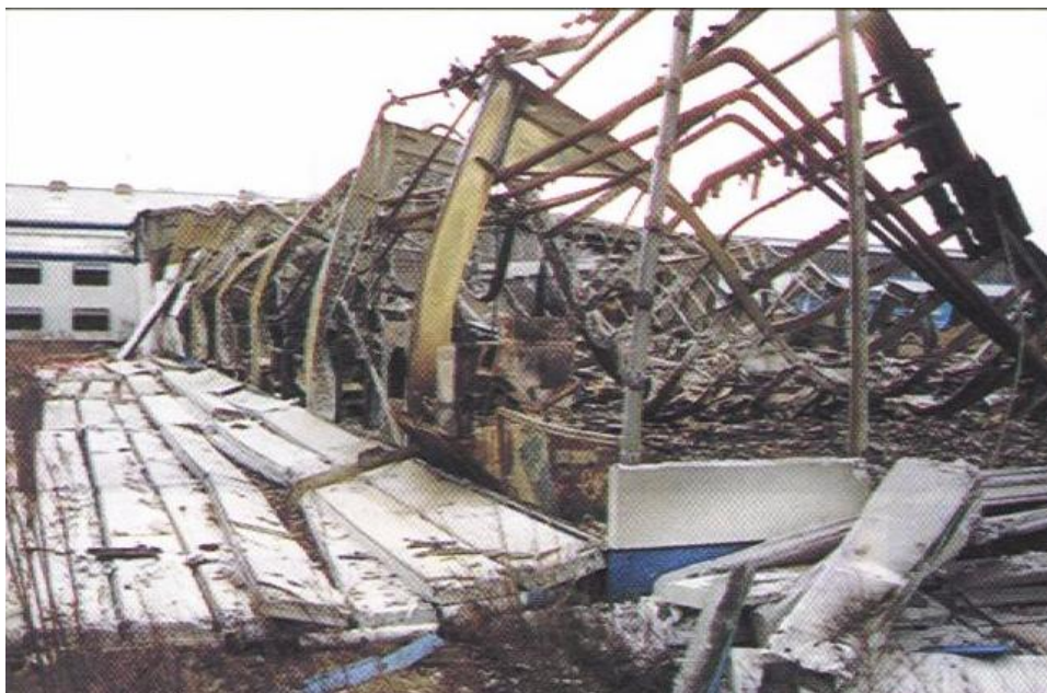
Slika 2: Nezaščitenjena jeklena konstrukcija s primerno EI 90 požarno odporno fasadno oblogo po požaru. Ker sistem požarne zaščite ni bil izveden v celoti, je bila investicija v primerno požarno odporno fasado, zaman. (Vir: Brandschutz Atlas)
