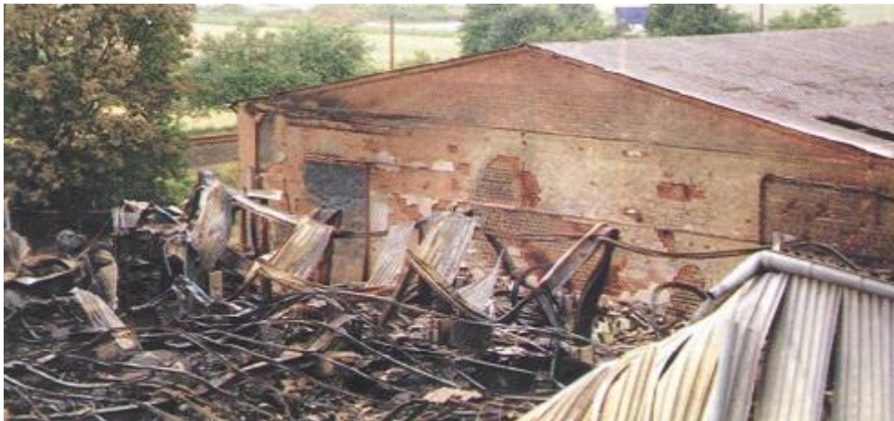
Slika 1: Jeklena konstrukcija po požaru (Vir: Brandschutz Atlas)
