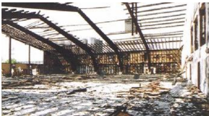
Slika 1: Lesena konstrukcija po požaru. Zaradi velikosti preseka ni prišlo do porušitve lesenih nosilnih elementov. (Vir: Brandschutz Atlas)
