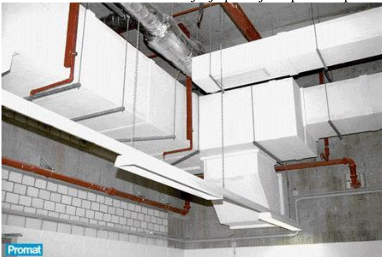
Slika 11: Primer izvedenega kanala za odvod dima in toplote
