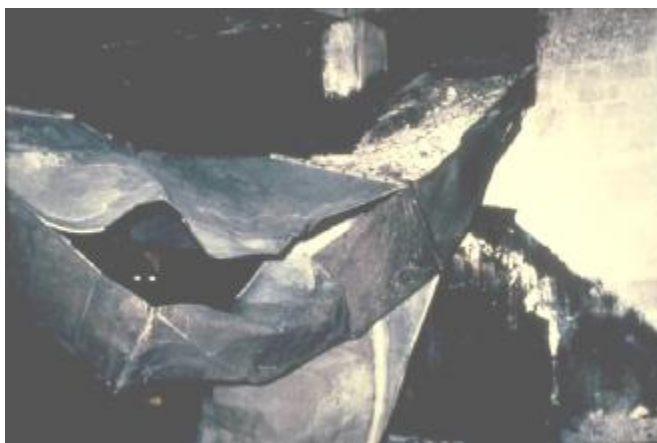
Slika 3: Pločevinast kanal po požaru
