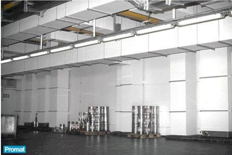
Slika 12: Primer izvedenega kanala za odvod dima in toplote
