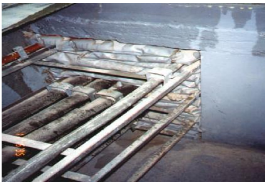
Slika 16: Zapora prehoda električnih vodnikov s požarnimi blazinicami.
