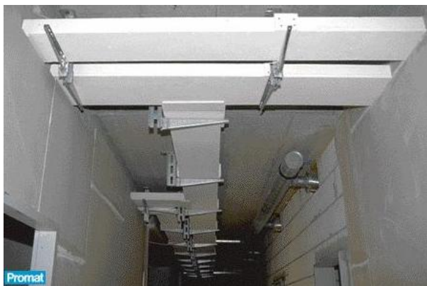
Slika 5: Primer izvedenega elektro instalacijskega kanala
